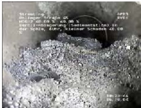
Abbildung 2: Hindernisse in Grundleitung
